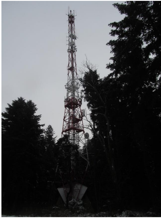
Zał. nr 1: Widok ogólny instalacji radiokomunikacyjnej.
